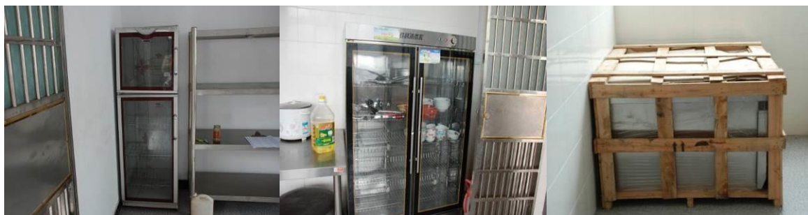
图 10 设备未正常使用（消毒柜有损坏未修）
