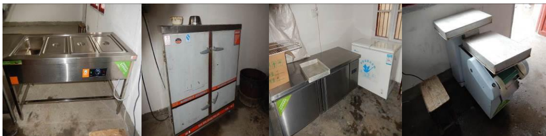
图 17 厨房设备正常使用组图
