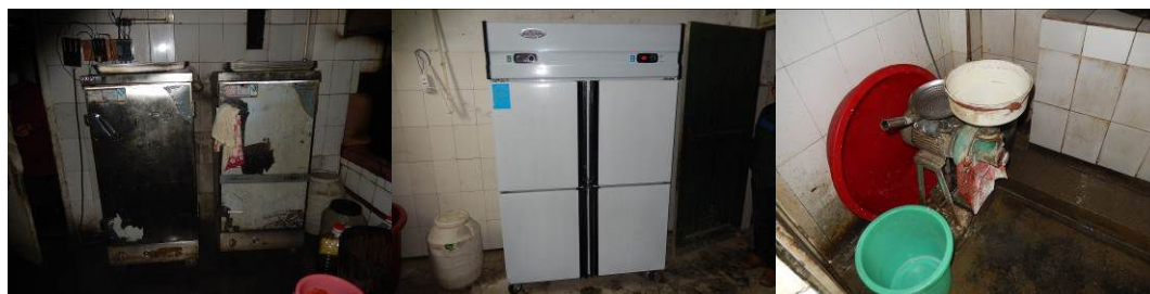
图 19 厨房设备正常使用组图
