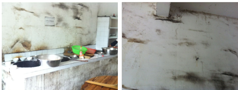
图 7 厨房墙面卫生情况组图
