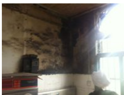
图 8 厨房墙面情况图
