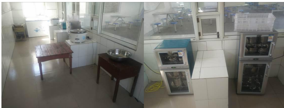
图 14 正常使用的厨房设备组图
