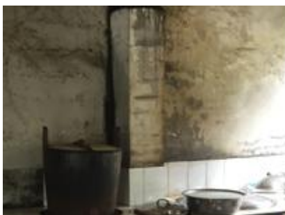
图 5 厨房墙面卫生情况图
