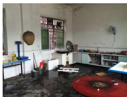
图 5 厨房墙地面情况图
