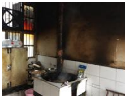
图 5 厨房墙面卫生情况
