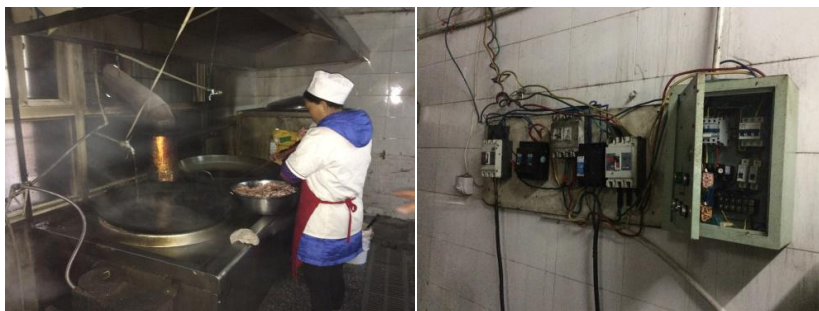
图 4 灶台上方墙体及裸露电闸情况组图
