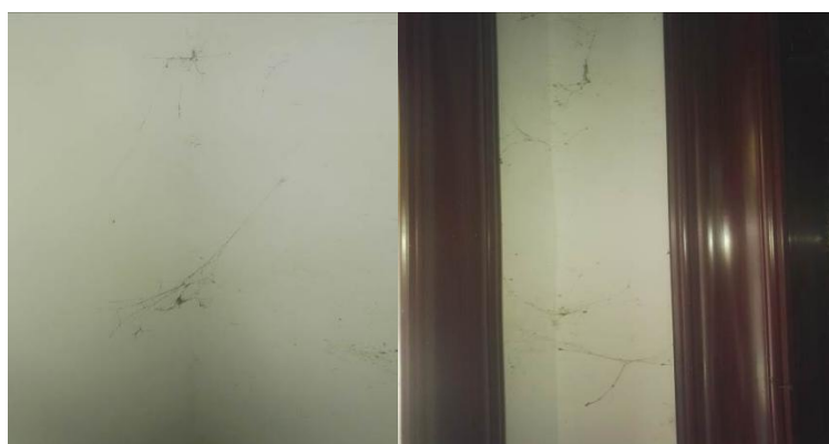
图 6 厨房墙面卫生情况组图
