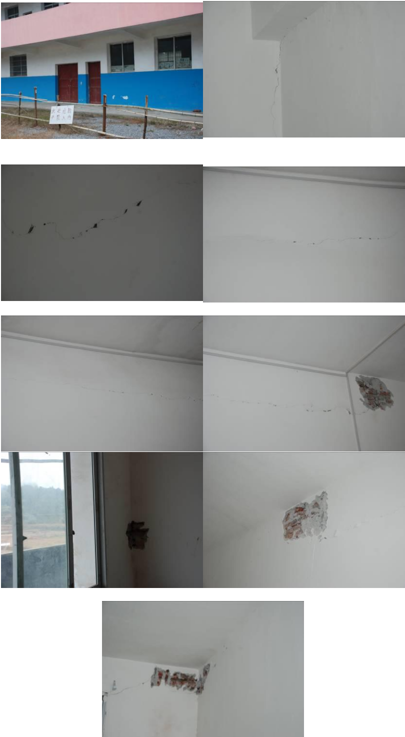
图 2 学校综合楼危险情况组图
