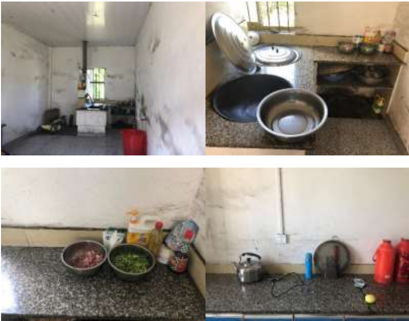
图I-2 厨房卫生情况组图
