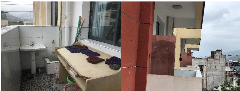
图III-3 位于各班教室后面的洗手台
